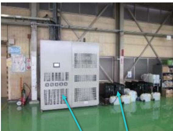
1期工事 出力60kW
