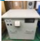
非常用蓄電池
